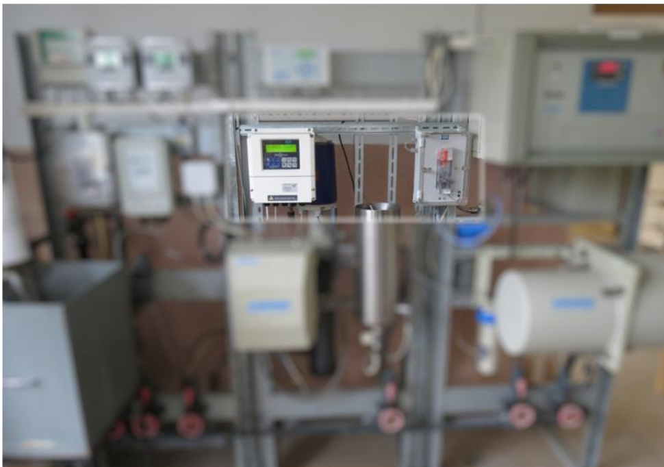
Przykład zrealizowanej instalacji: CHLORTROL + Micro2Chem mierzy ClO 2 w SUW
